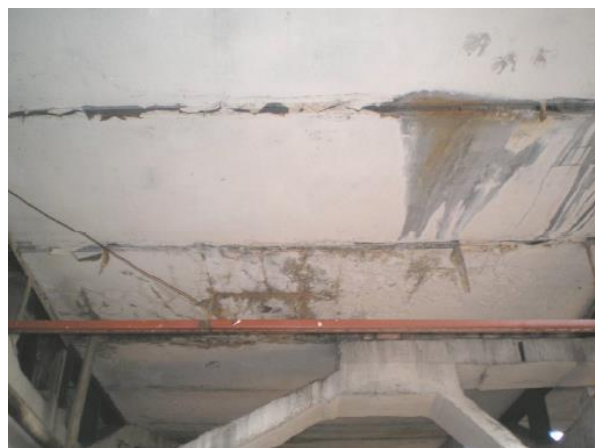
Рис. 5. Внешний вид конструкции покрытия. Следы замачивания, прогиб плиты
