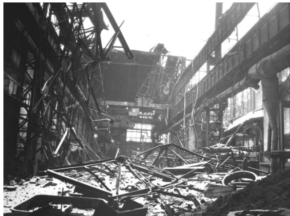
Рис. 3. Общий вид обрушения конструкций покрытия цеха литейно-арматурного завода в г. Пензе Fig. 3. General view of the collapse of the coating structures of the foundry and reinforcement plant in Penza
