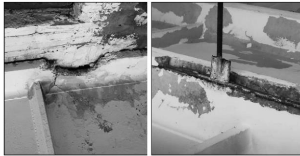
Рис. 2. Механические повреждения продольных ребер плиты покрытия Fig. 2. Mechanical damage to the longitudinal ribs of the coating plate
