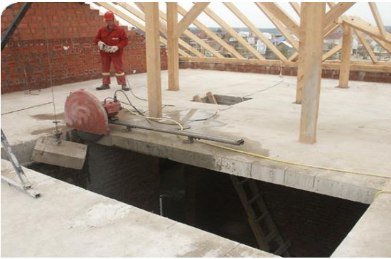
Рис. 8. Алмазная резка проема в перекрытии без надлежащих мероприятий по безопасности производства Fig. 8. Diamond cutting of an opening in an overlap without proper production safety measures
