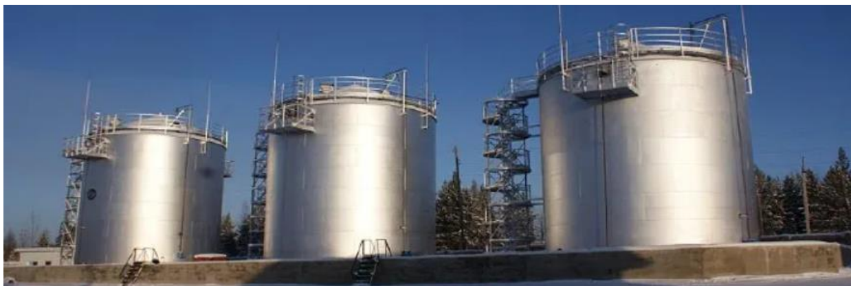
Рис. 3. Группа стальных вертикальных резервуаров Fig. 3. Group of steel vertical tanks
