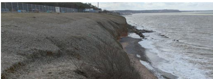
Рис. 8. Разрушенная берегозащита в районе пансионатов «Искра» ООО «Укртелеком», пионерского лагеря «Стройиндустрия», берегоукрепительные сооружения пляжа общего пользования, панс. «Минмонтажспецстрой», пансионата «Волна».
