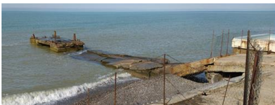
Рис. 5. Берегоукрепительные сооружения базы отдыха «У Лукоморья». Южнее разрушенного причала.
