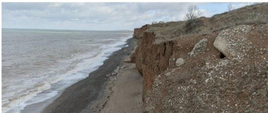
Рис. 4. Естественный клиф на месте разрушенных берегоукрепительных сооружений в районе базы отдыха «У Лукоморья».
